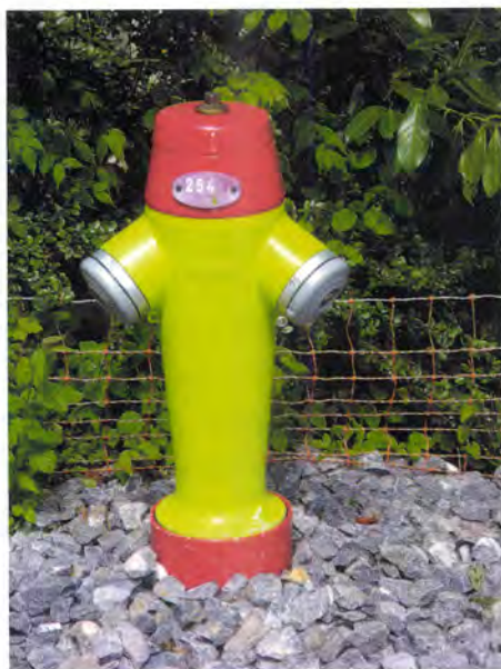
Hydrant Hinni – Im Brünneli in Aesch.
