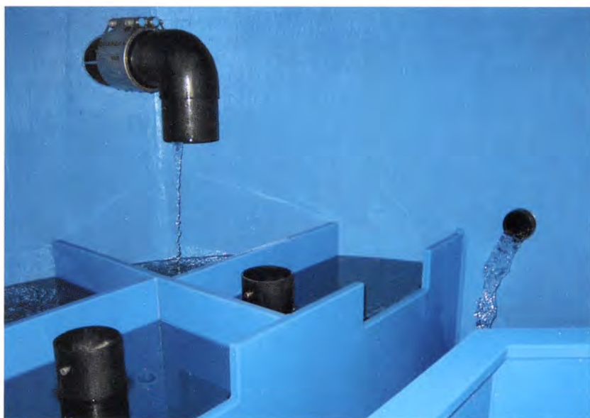
Wassereinlauf in eine Brunnenstube.
