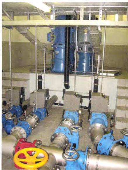
Blick in den Pumpenraum. Energie Uster AG
