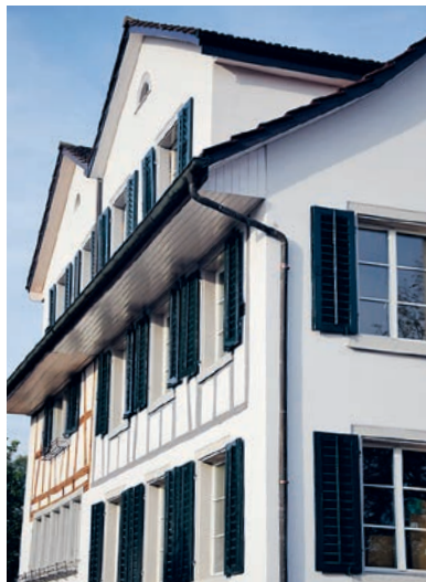
Entdeckung: Die Fachwerkfassade war früher verdeckt.
